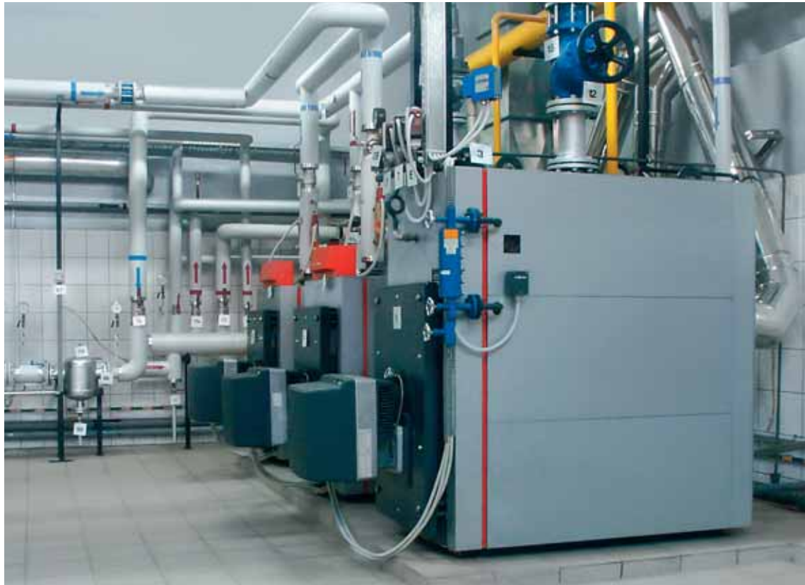
Anlage mit einem Vitoplex LS Niederdruck-Dampferzeuger sowie zwei Vitoplex Heißwassererzeugern
