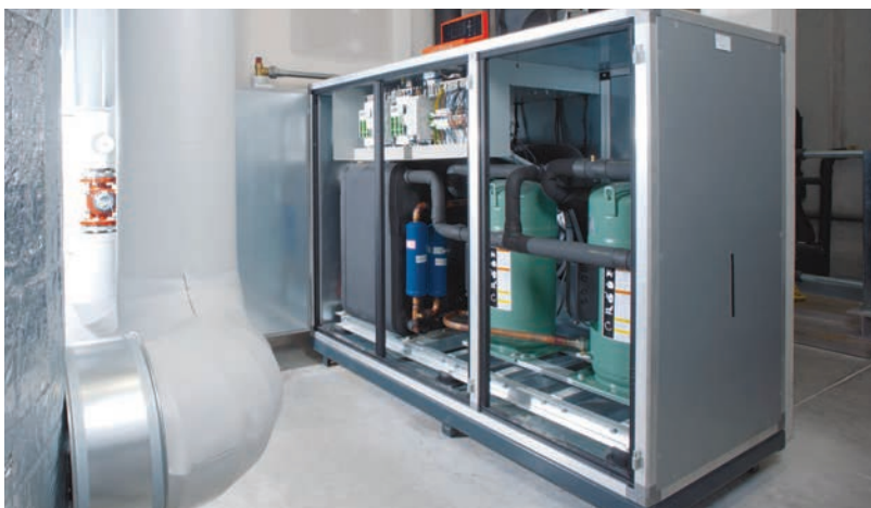
Растворно-водяные тепловые насосы Vito- sal 300-G Pro каждый мощностью 150 кВт
