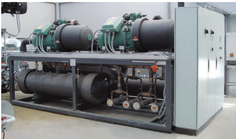
Водо-водяной тепловой насос мощностью 1560 кВт
