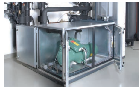
Взгляд на установку изнутри: эффективный компрессор в шумо-и виброизоляционном корпусе.
