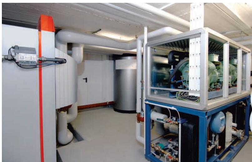
Три многоквартирных дома обеспечиваются теплом рассольно-водяных тепловых насосов мощностью по 75 кВт каждый.
