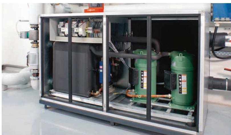
Рассолно-водяной тепловой насос 2 x Vitocal 300-G Pro, мощность 2 x 242 кВт
